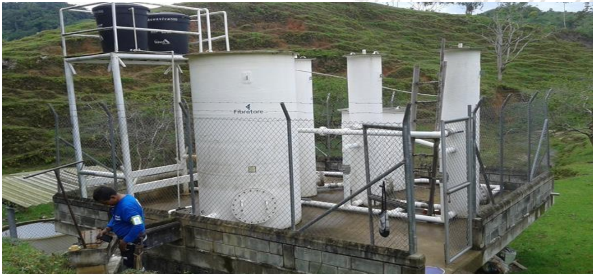
Imagen 1. Planta de tratamiento de agua cruda (potabilizadora) del corregimiento la Floresta Maceo.
