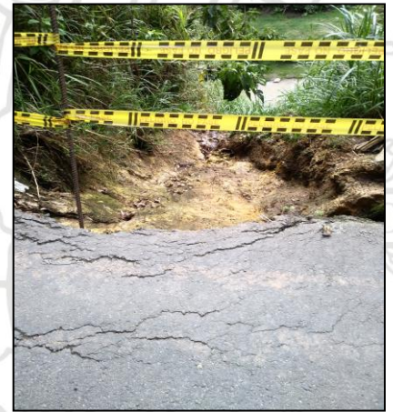
Imagen 2. Vías desestabilizadas por movimientos en masa (Derrumbes) Obra OESAP. Fuente: Propia
