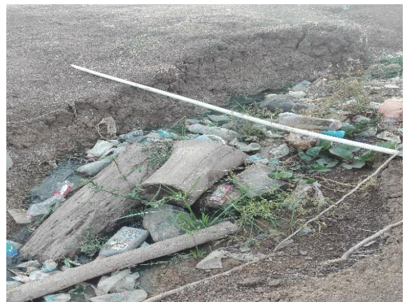
Figura 14. Residuos Sólidos acumuladas en zanjas
