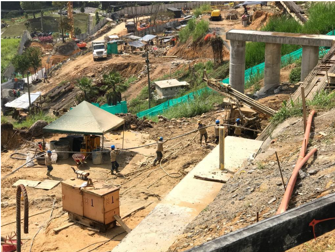
Fotografía 5 - Equipamiento de anclaje
