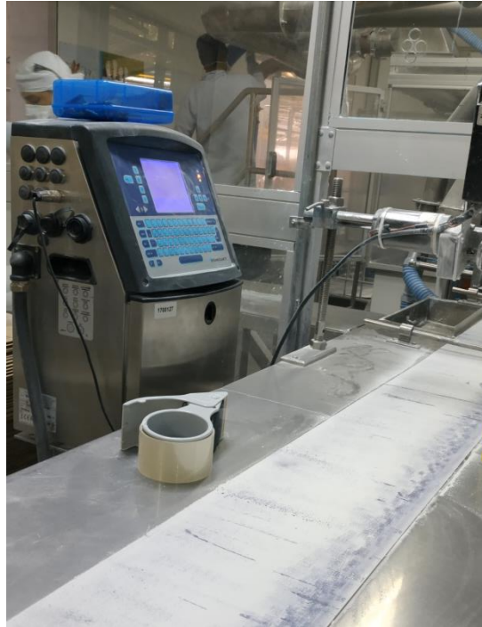
Figura 8. Línea de producción de talcos. Se observa claramente en la imagen que el equipo CIJ se encuentra en contacto directo con polvos nocivos para el correcto funcionamiento del equipo.
