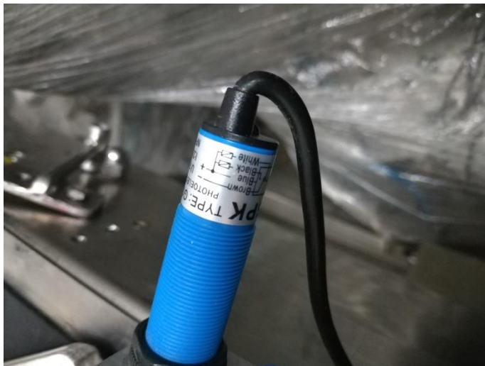
Figura 16. Problema en el cable del sensor. Se observa un ángulo que termina siendo perjudicial para el sensor debido a que con el tiempo agrieta los filamentos.
