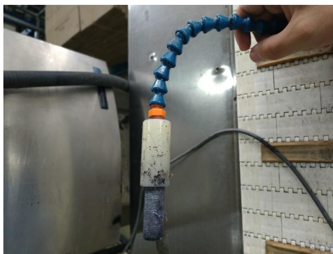
Figura 17. Elemento instalado en el cable del sensor para evitar que este sufra daños.
