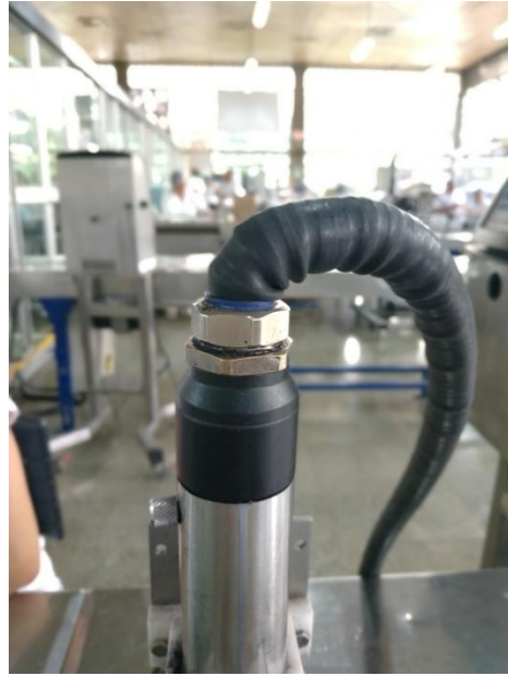
Figura 14. Problema de fisuramiento del umbilical. Claramente se observa como por el peso del mismo umbilical se ha ido partiendo provocando un daño considerable en el mismo.
