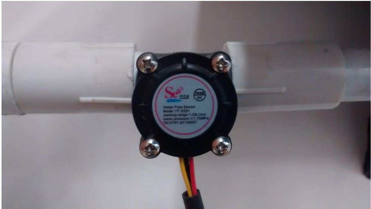
Figura 27: Sensor de flujo montado en la planta.
