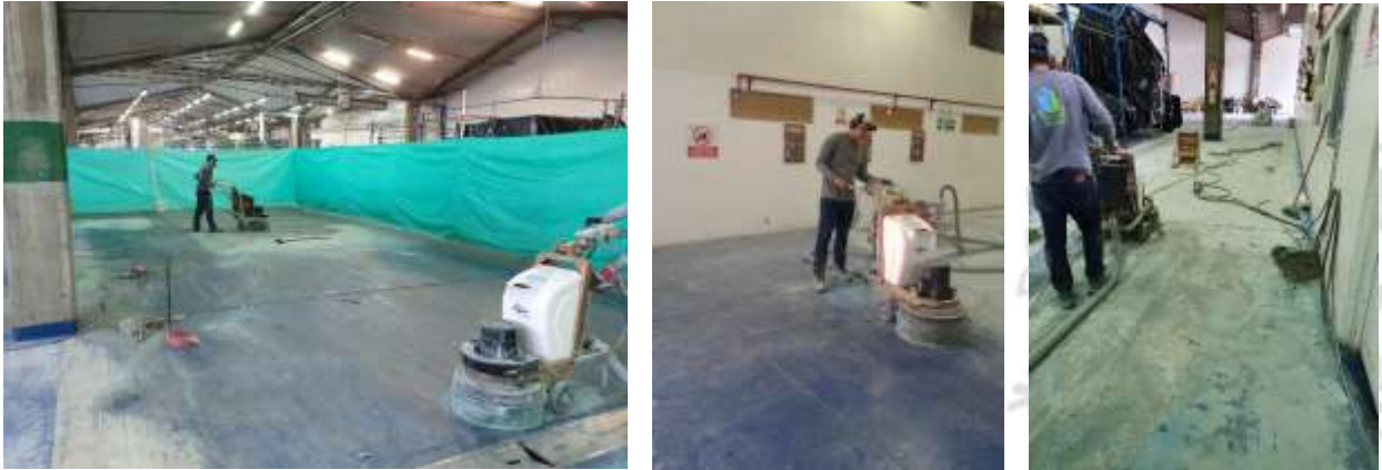
Figura 27-29. Destroncado de la superficie de piso para retiro de pintura existente (Elaboración propia).
