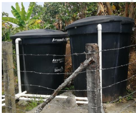
Figura 4. Tanque de almacenamiento
