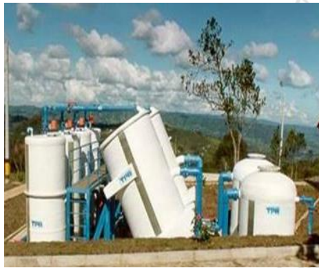
Figura 3. Planta de tratamiento de agua potable. Tomada por: Carlos Hincapié
