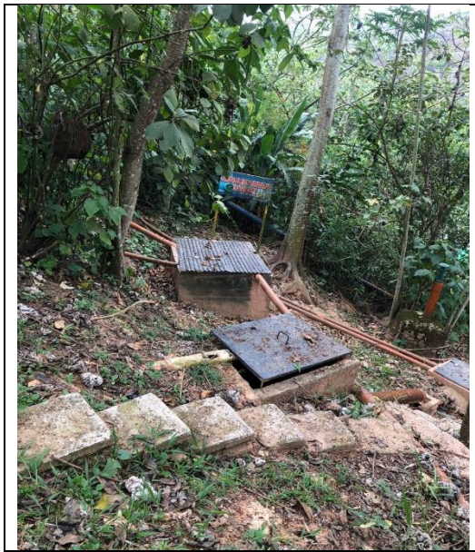
Foto 4 , Drenes y tanques de inspección de lixiviados.
