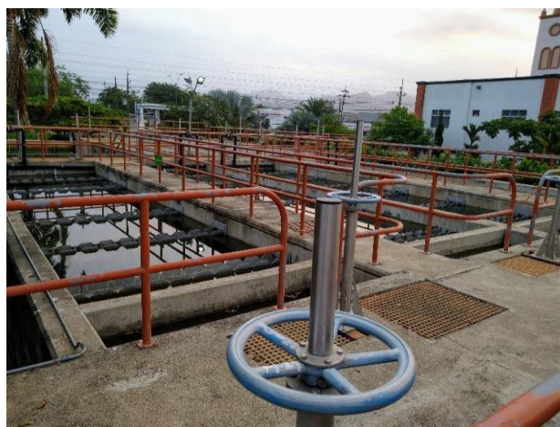
Figura 2. Unidades de Floculadores de la planta Apartadó. Fuente: Propia
