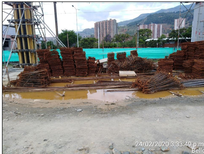
Figura 3. Acopios del material mal definidos.
