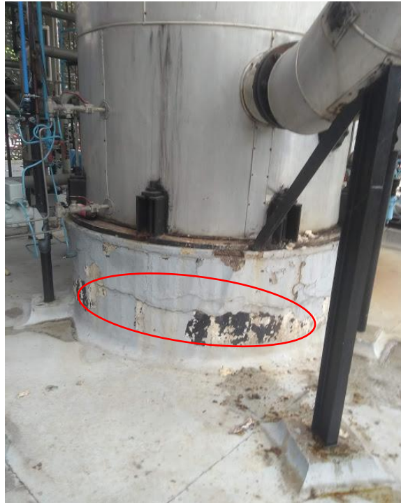
Fotografía 26. Tanque de la torre destiladora con muestras de humedad, manchas y fisuras en su base.
