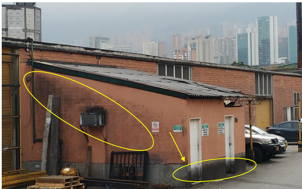
Fotografía 19. Deterioros por la humedad en el cuarto de seguridad industrial.
