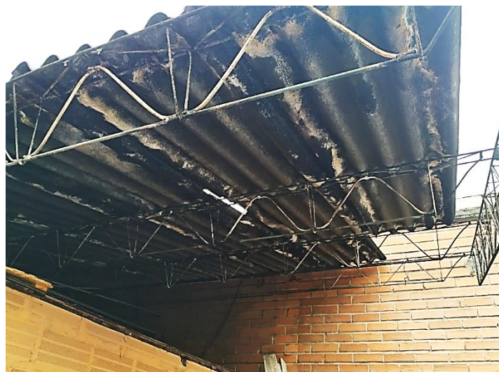
Fotografía 20. Afectaciones en la cubierta del cuarto de seguridad industrial.
