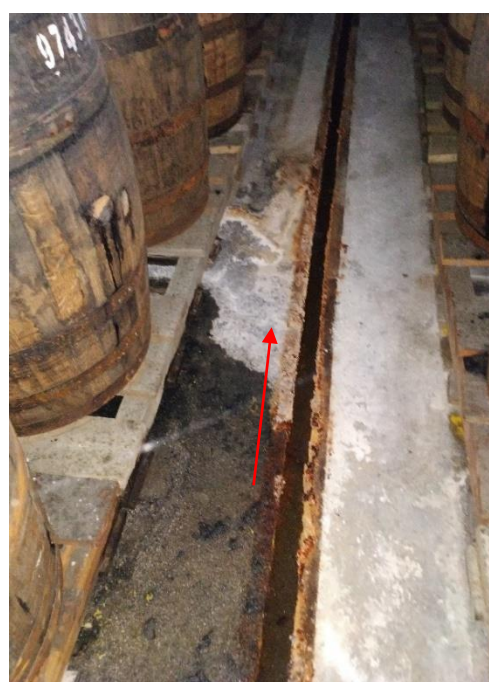
Fotografía 14. Eflorescencia sobre cárcamos de bodega número de rones número 3.
