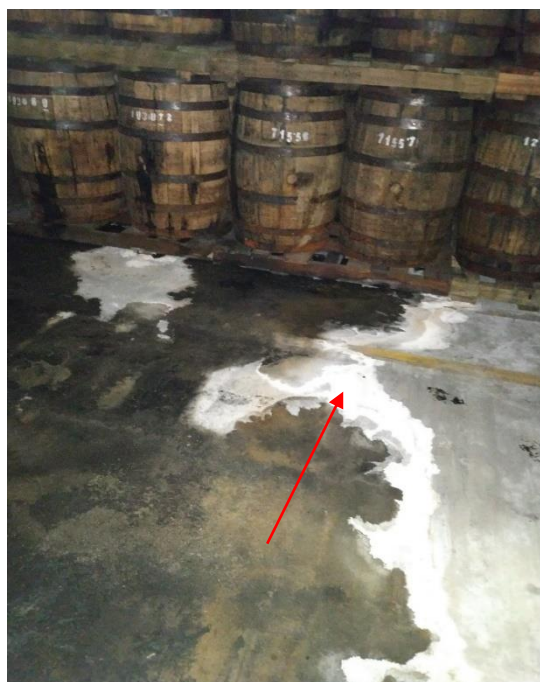
Fotografía 13. Eflorescencias sobre piso de concreto de bodega de rones número 3.
