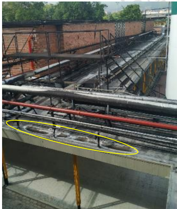
Fotografía 3. Apoyos sobre la losa de los corredores de la fábrica y acumulación de agua sobre la misma
