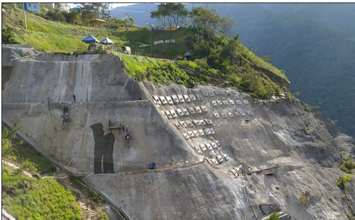
Imagen 4. Anclajes activos – Tensores con barra Dywidag y drenes horizontales. Tomado de: elaboración propia.
