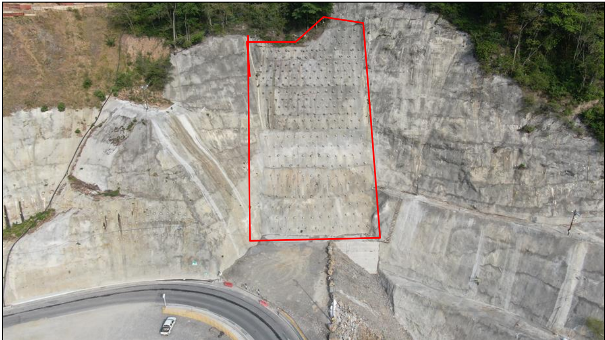
Imagen 8. Construcción de pantalla activa conformada por tensores compuestos de cable o torones, anclas, malla y concreto lanzado. Tomado de: elaboración propia.
