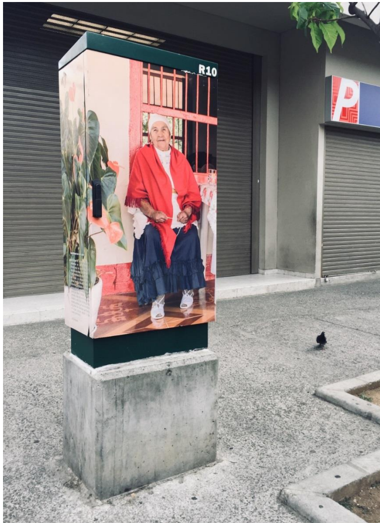
Fotografía 09. Gabinetes de energía ahora decorados con fotografías de los campesinos de la región y sus historias de vida. Tomada el 20 de junio de 2019. Fuente elaboración propia
