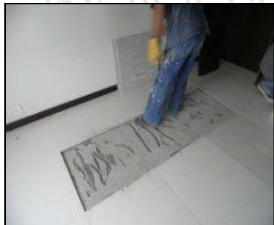
Figura 8. Levantado de baldosas sueltas. Fuente: Vera (2012)
