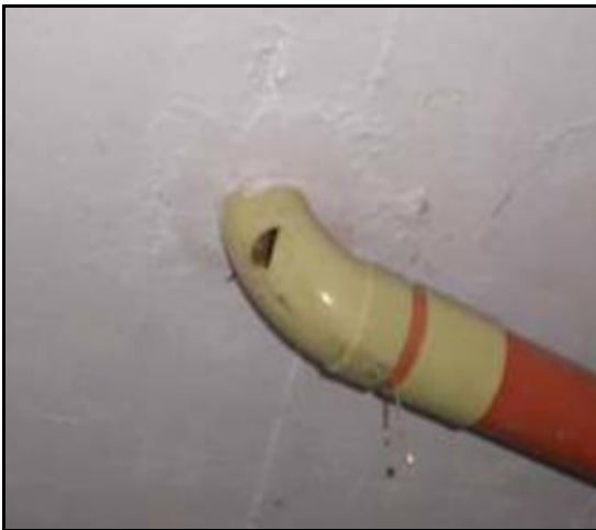
Figura 5. Rotura de codo 3" PVC sanitario. Fuente: Vera (2012)
