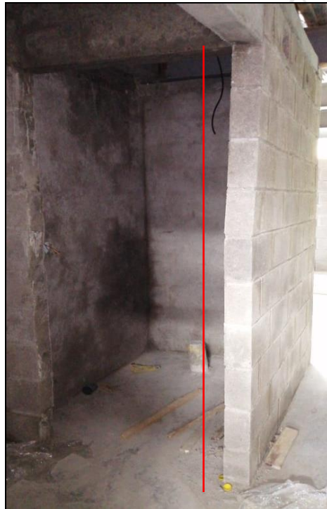
Figura 9. Muros con desplomes. 2020 Fuente: Creación propia.
