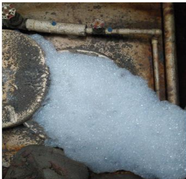
Imagen 6. Problema de espuma reactor aerobio.
