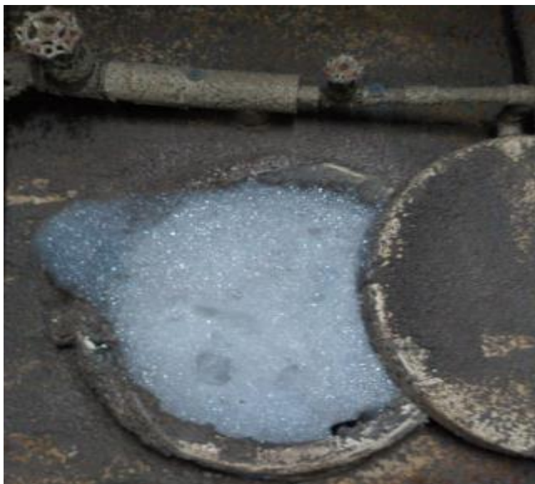
Imagen 4. Reactor de lodos activados, con presencia de espumas y expulsión de lodos.
