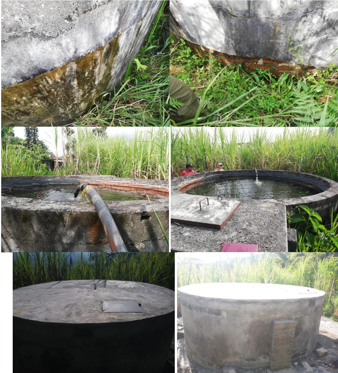
Ilustración 7 Antes y Después del mejoramiento del tanque de almacenamiento de la vereda la divisa
