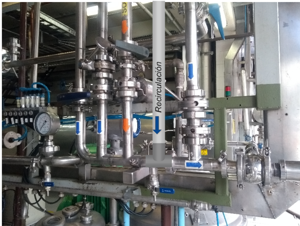
Imagen 43. Tubería de entrada centrífuga #7
