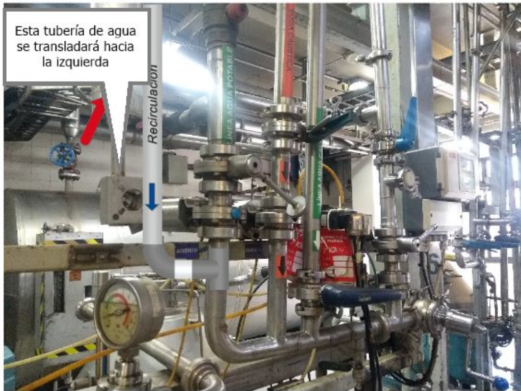
Imagen 42. Tubería de entrada centrífuga #6
