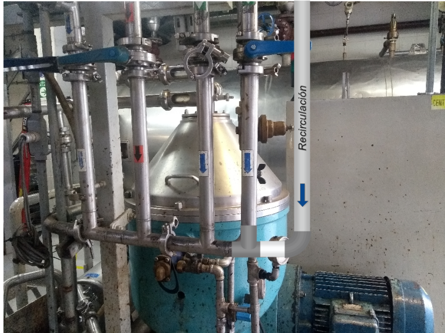
Imagen 40. Tubería de entrada centrífuga #4
