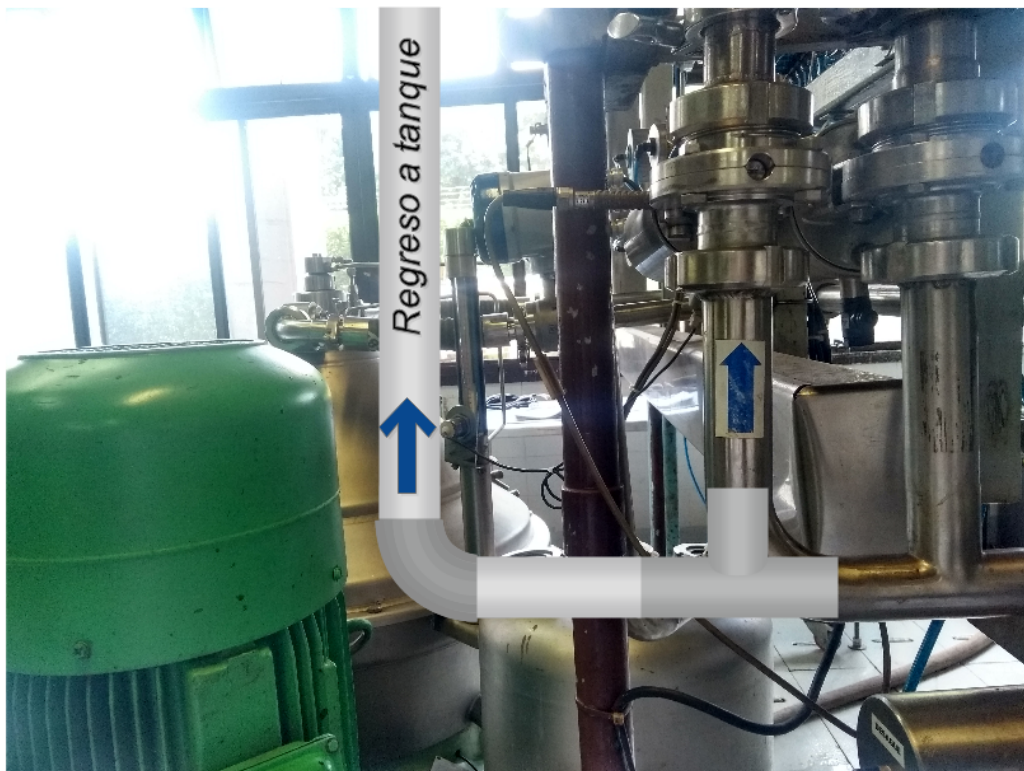
Imagen 48. Tubería de salida centrífuga #7
