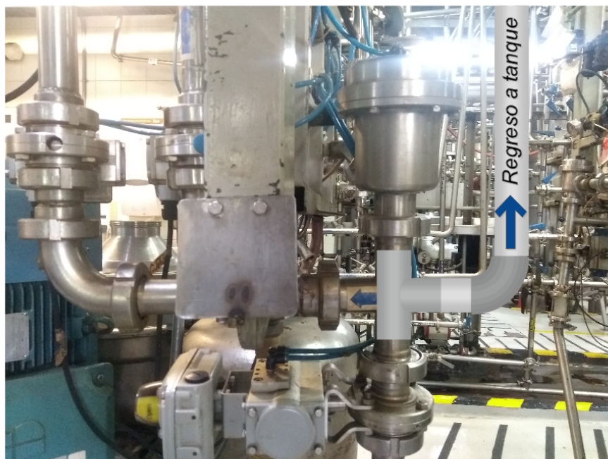
Imagen 46. Tubería de salida centrifuga #5
