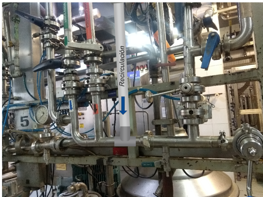
Imagen 41. Tubería de entrada centrífuga #5
