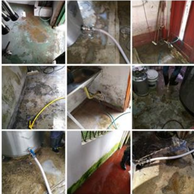
Figura 3. Encharcamiento y humedades.
