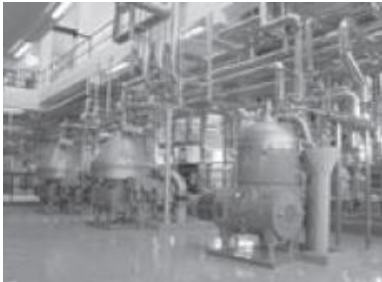
Figura 18: Red de tuberías en una instalación industrial, según Cengel.
