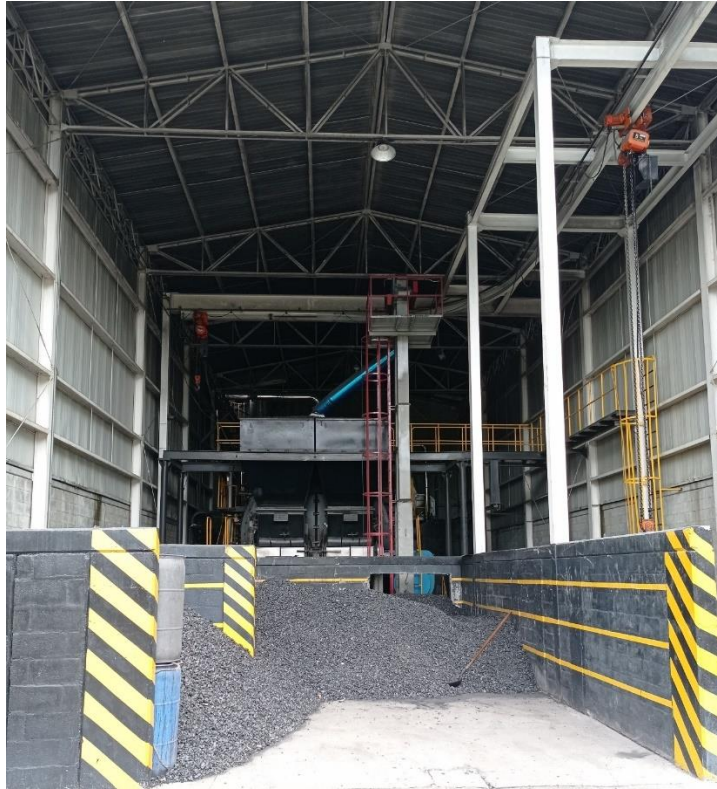
Imagen 19. Zona de caldera en Lavandería
