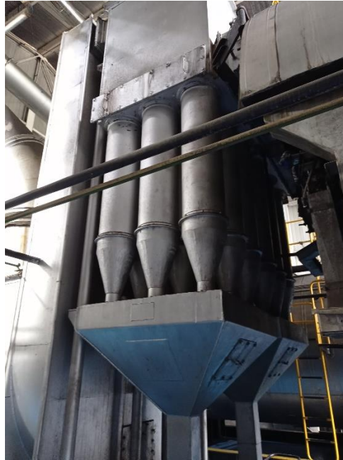
Imagen 21. Multiciclón de la caldera de Lavandería
