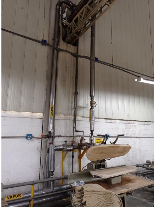
Imagen 23. Derivación de vapor a Termijeans
