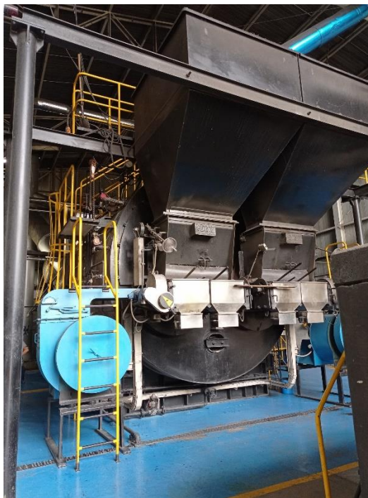
Imagen 20. Caldera de Lavandería
