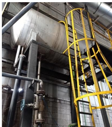
Imagen 22. Almacenamiento de los condensados
