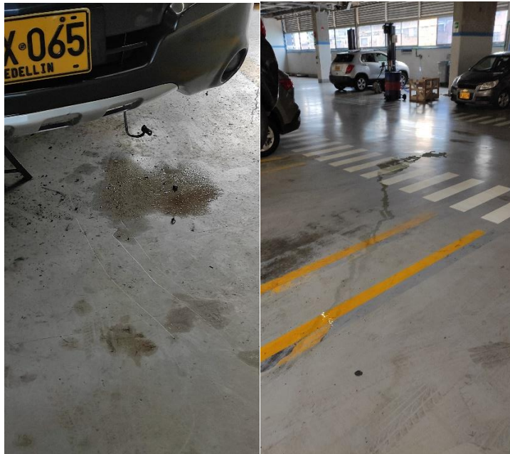
Imagen 18. Derrames en los pisos del taller que pueden ocasionar accidentes.
