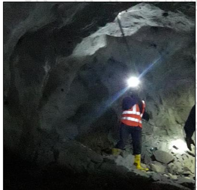
Figura 16. Desabombe de la bóveda y hastiales posterior a la voladura. Elaboración propia
