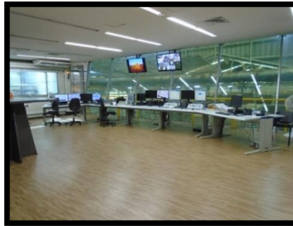
Imagen 4 Sala de control "Control room"
