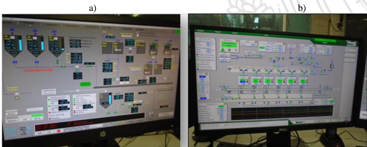
Imagen 3 Sistema de control la cocina y del HIT-JET, a) control área de cocina, b) control del HIT-JET
