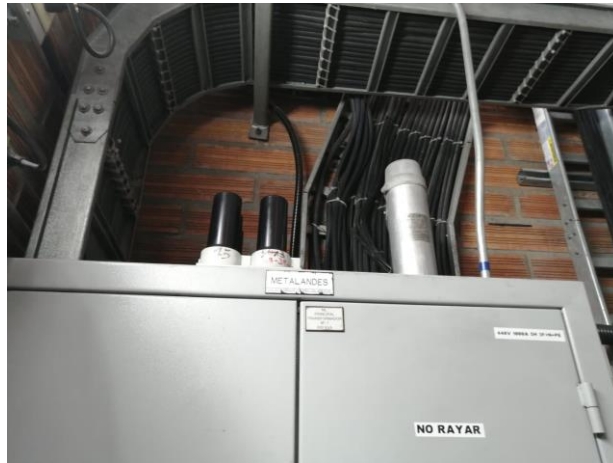
Figura 17. Capacitores existentes subestación 14.
