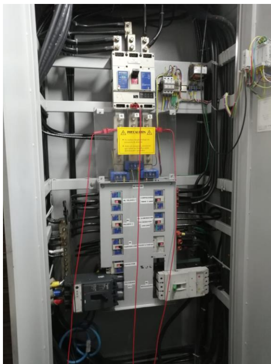
Figura 19. Tablero de distribución principal subestación 15.
