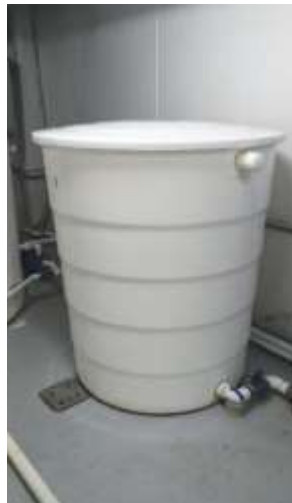
Figura 6. Tanque de contacto
