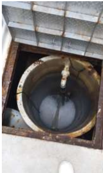
Figura 4. Tanque de trasiego
