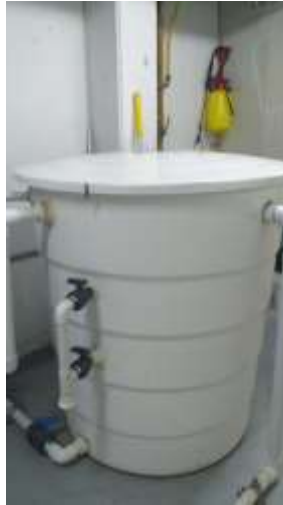
Figura 7. Tanque de espesador de lodos
