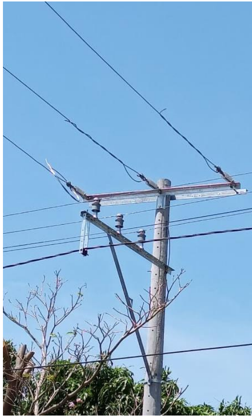
Fig. 3. Conductores de la red de distribución en configuración especial.
