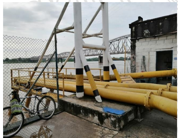
Ilustración 7. Tubería de succión.
