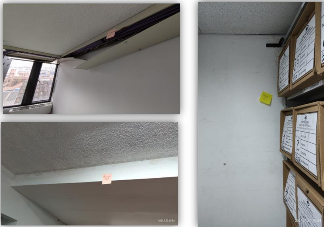
Figura 6 Humedades debido a filtración
