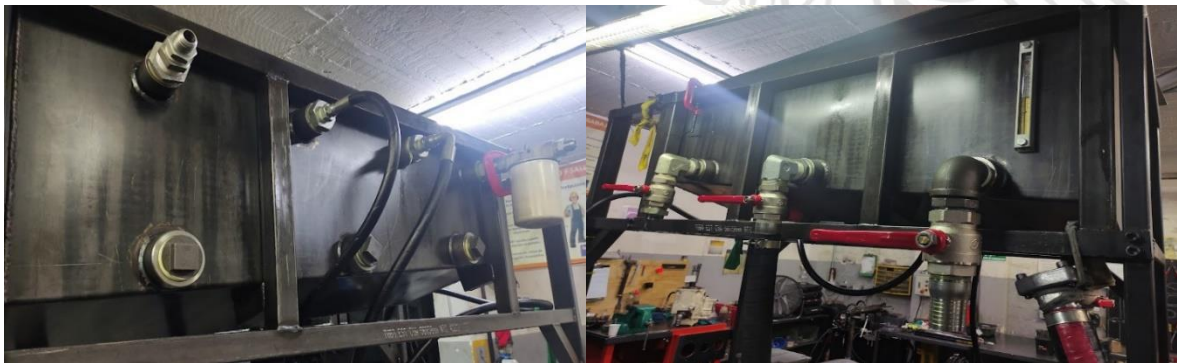
Ilustración 36. Puertos de retorno y de succión del tanque actualmente.
