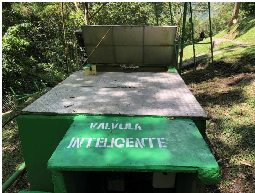
Foto 6. Tanque de entrada. Nota: Fuente propia.
