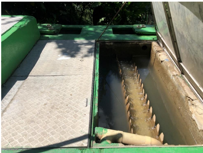
Foto 13. Filtros rápidos convencionales de flujo descendente Nota: Fuente propia.
