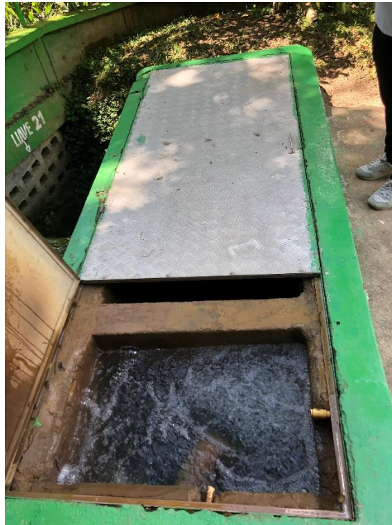
Foto 11. Prefiltros con material filtrante grueso. Nota: Fuente propia.
