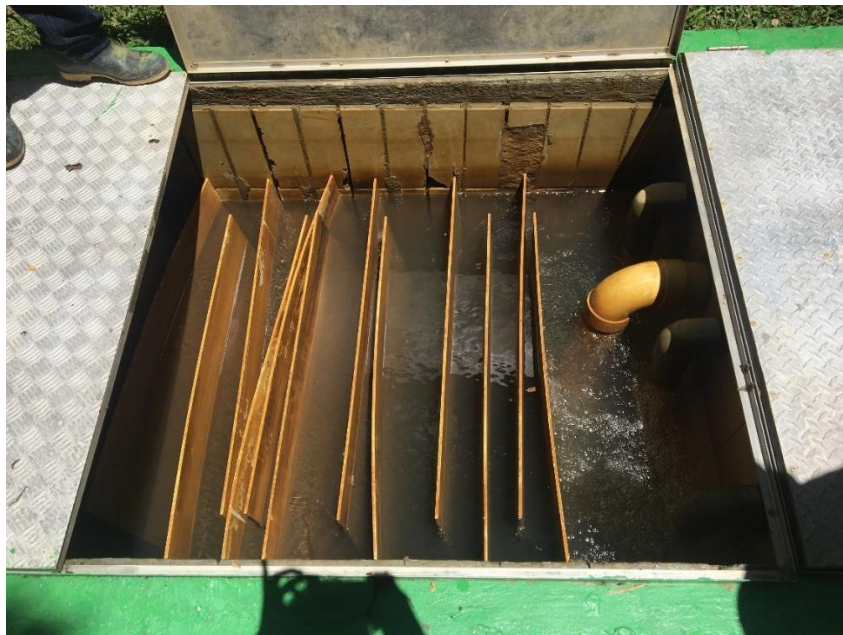
Foto 9. Floculador hidráulico de flujo horizontal. Nota: Fuente propia.
