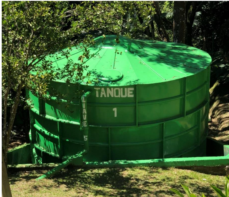
Foto 15. Tanque de almacenamiento número 1. Nota: Fuente propia.
