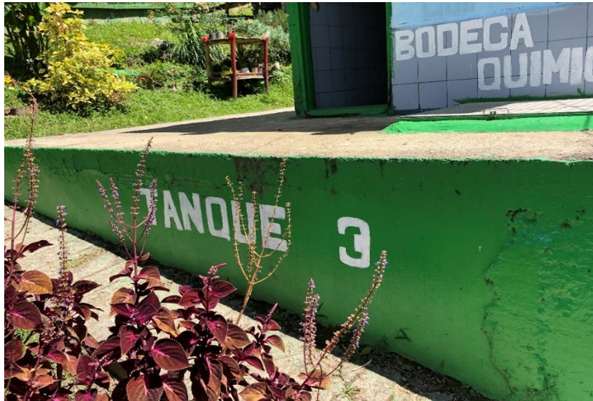
Foto 17. Tanque de almacenamiento número 3. Nota: Fuente propia.
