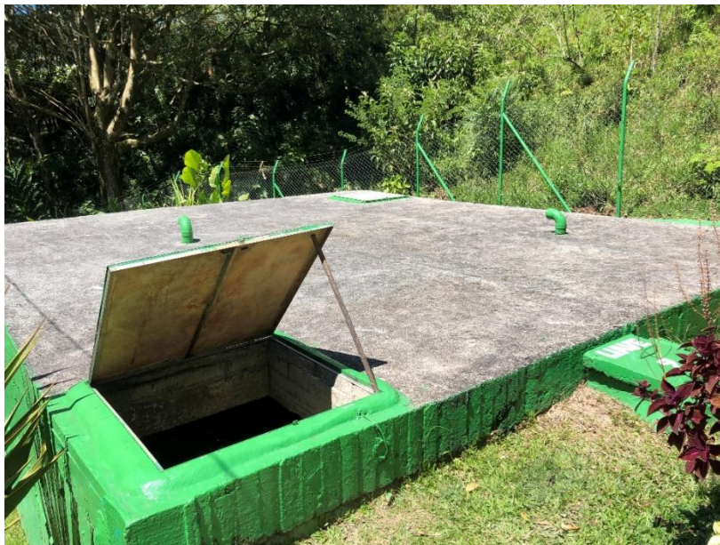
Foto 16. Tanque de almacenamiento número 2. Nota: Fuente propia.
