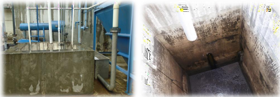
Ilustración 3. Tanque colector inicial. Fuente: Propia
