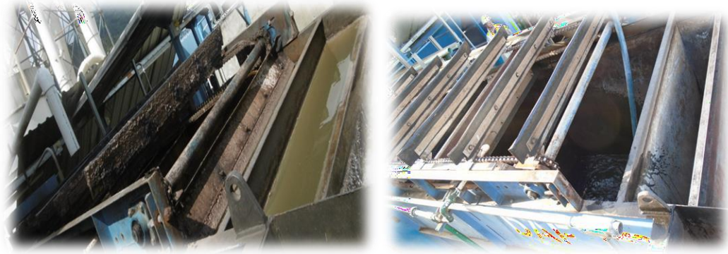
Ilustración 6. Celda de flotación DAF. Fuente: Propia
