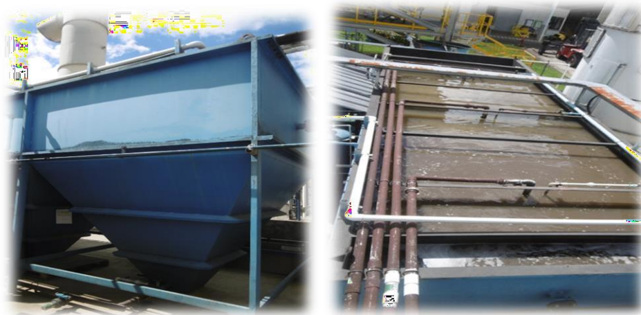
Ilustración 12. Tanque clarificador biológico. Fuente: Propia
