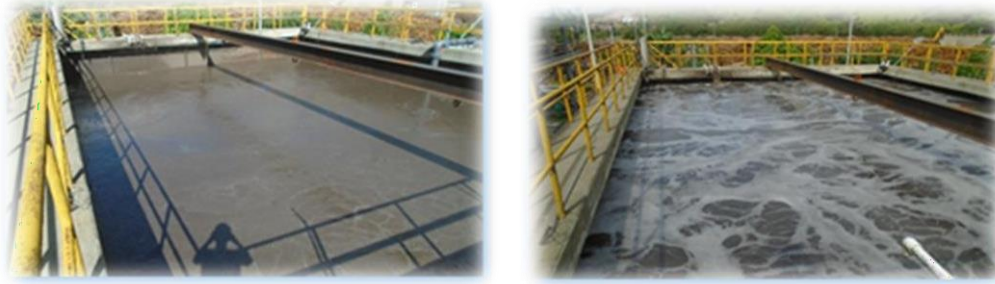
Ilustración 11. Reactor Biológico. Fuente: Propia
