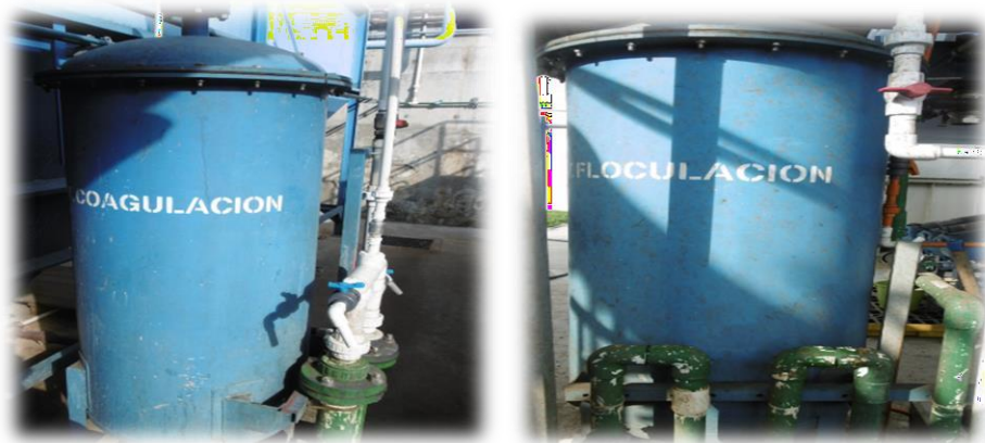
Ilustración 5. Tanques dosificación de químicos. Fuente: Propia
