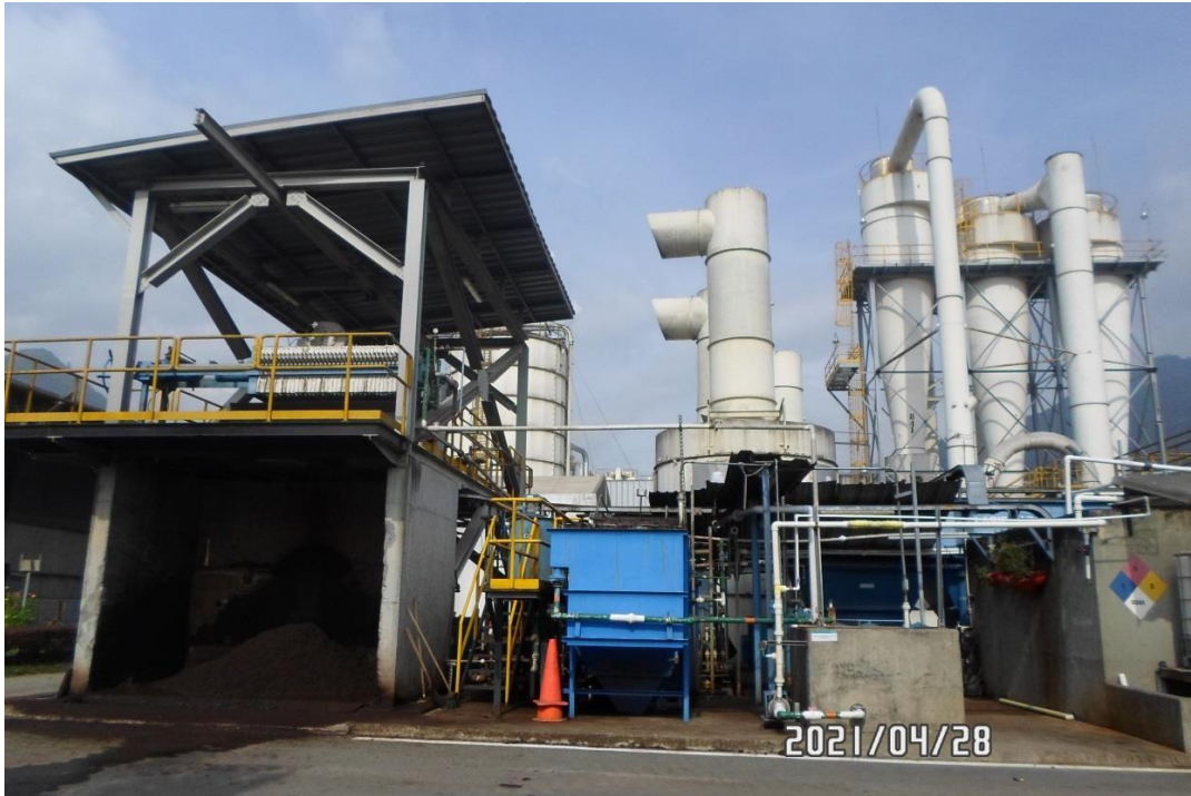
Ilustración 2. Planta de tratamiento de aguas residuales (industrial y domestica) Fuente: Propia.
