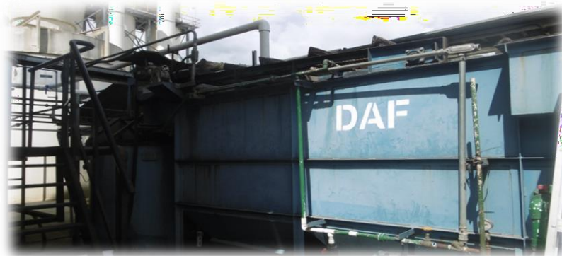
Ilustración 7. Flotación por aire disuelto (DAF). Fuente: Propia
