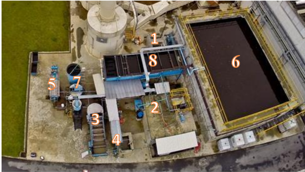
Ilustración 1. Planta de tratamiento de aguas residuales. Fuente: propia
