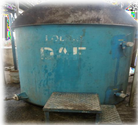
Ilustración 8. Tanque de lodos DAF. Fuente: Propia
