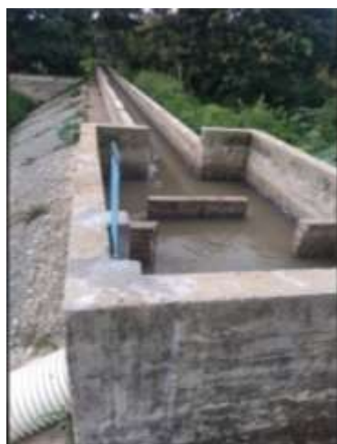
Figura 5. Canal de entrada de las aguas residuales
