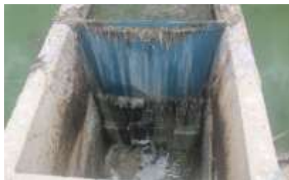
Figura 6. Compuerta de desagüe del sistema de tratamiento
