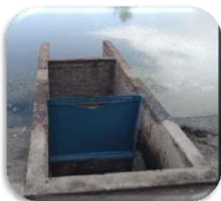
Figura 10. Compuertas de desagüe
