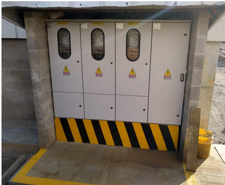
Figura 21. Gabinete de medida y protección, bodegas de la 6 a la 8.
