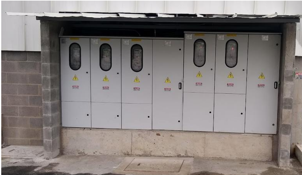
Figura 20. Gabinetes de medida y protección, bodegas de la 1 a la 5.
