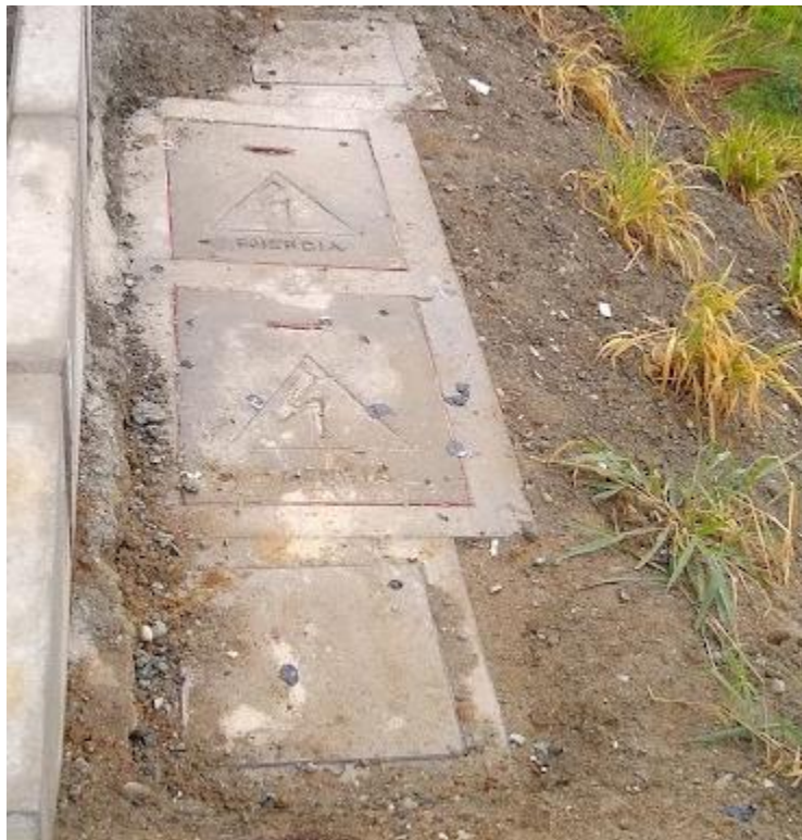
Figura 19. Cajas de paso.
