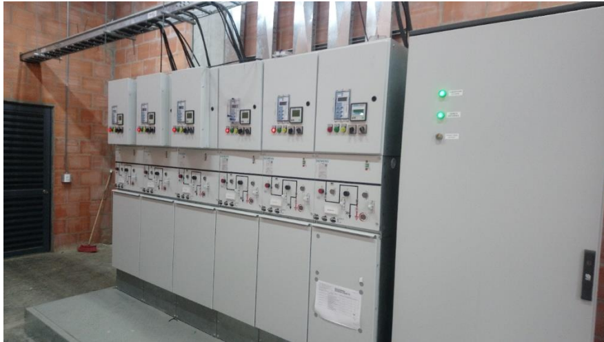
Fig. 9. Celdas de interruptores en media tensión. Celdas suministradas por siemens con interruptor SF6, seccionador y cuchilla de puesta a tierra. Medidor de potencia y relé de protección.
