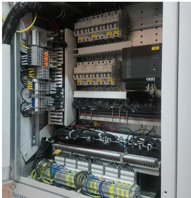
Fig. 10. Control del interruptor. Interior de la celda siemens. Diferentes señales de corriente y voltaje fueron llevadas a los tableros auxiliares del generador. Todos los comandos de apertura, cierre y disparo se realiza desde el tablero de sincronización.
