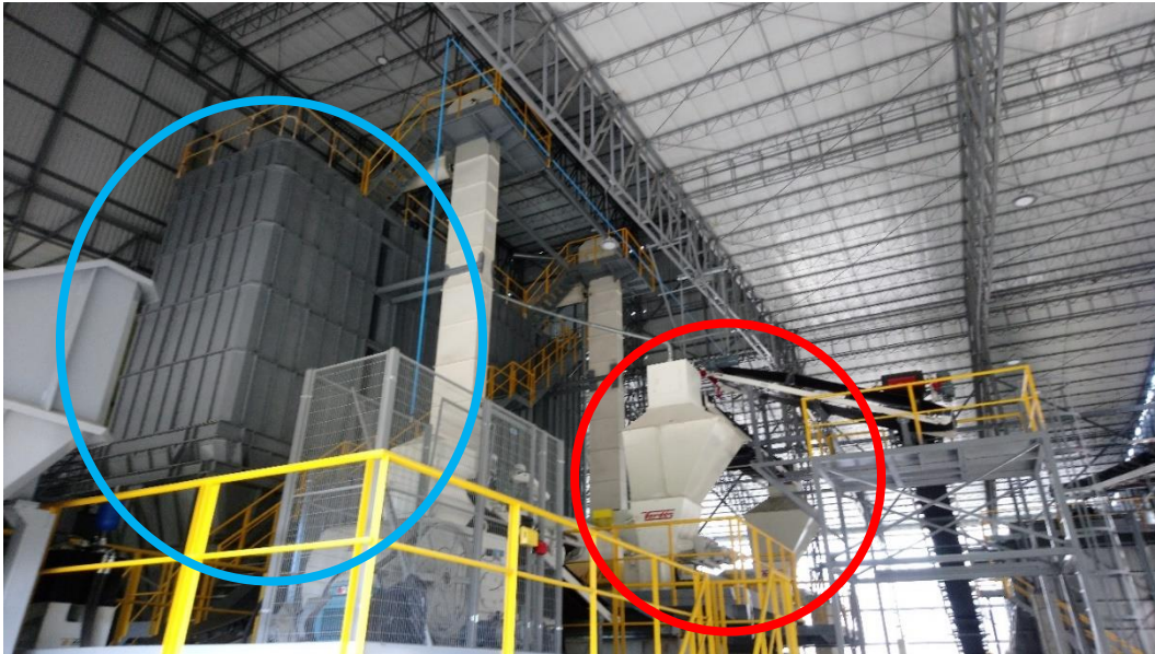
Fig. 3. Molinos y silos almacenamiento preparación. En azul, los silos de almacenamiento de materia prima seca. En rojo, los molinos de martillos que procesan la arcilla.
