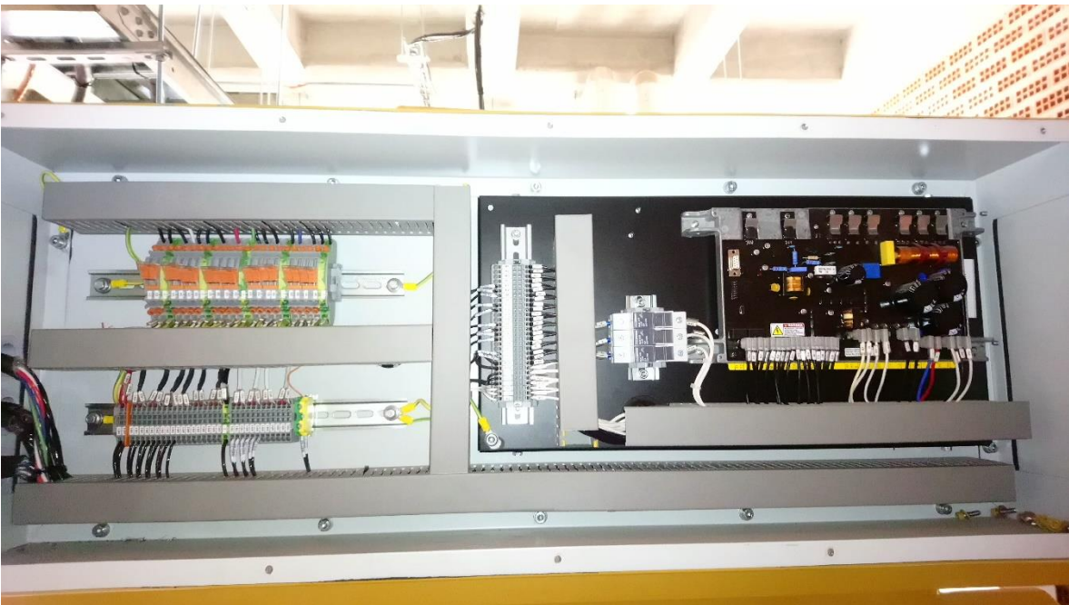
Fig. 12. Tablero de señales del generador 1. Desde este tablero, tenemos acceso a mediciones de corriente, tensión, temperatura y presión. Señales que son enviadas al control para su interpretación.
