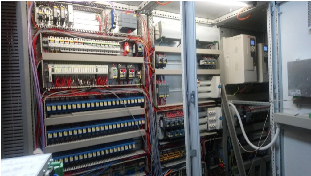
Fig. 8. Interior tableros auxiliares, HASI. Se observa todo el control y señales del generador, tablero encargado de alimentar los equipos en los circuitos de alta y baja temperatura. Realiza la acción ante la orden de control de la cogeneración.
