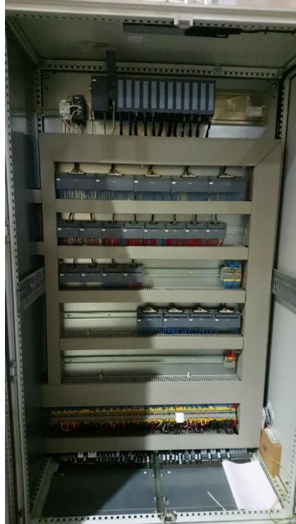
Fig. 5. Armario de control moldeo. En el armario de control, se ubica el PLC con el programa, se ejecuta y se vigila toda la zona de producción que comanda. Tiene comunicación con el control de preparación.
