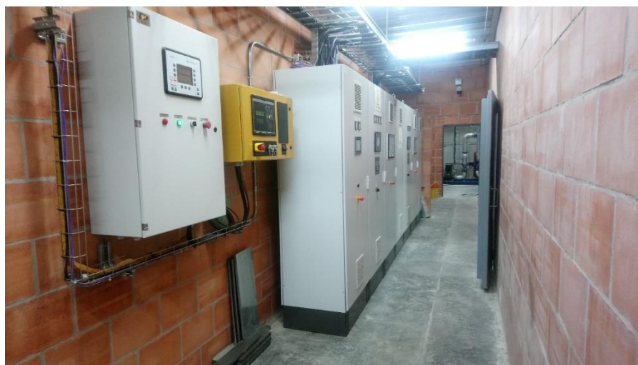
Fig. 7. Tableros auxiliares cogeneración. Gabinetes donde se comanda la sincronización automática y se supervisa el funcionamiento de todas las máquinas generadoras ubicadas en la subestación.
