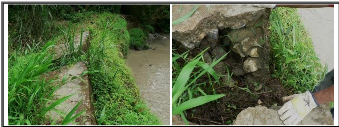
Figura 24. Falla en el muro de Gaviones (Balcázar, W. Gallego, S. et al. 2018).
