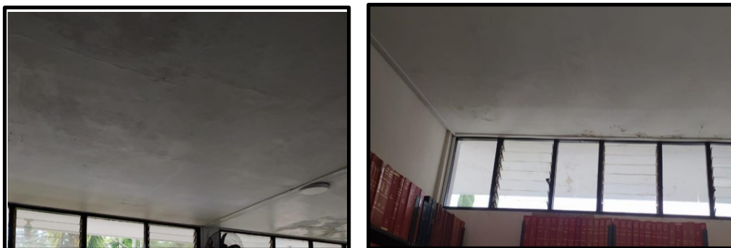
Ilustraciones 16 y 17. Humedad en depósitos de archivo Concejo municipal de Venecia.
