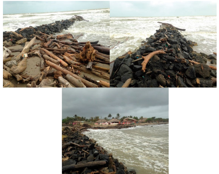
Figura 9.12 Espolón en la zona de Uveros. (Fuente: Elaboración propia - Componente Diseño de Obras).
