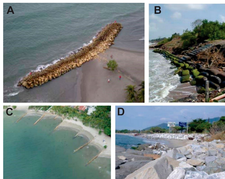
Figura 7.2.1 Estructuras duras utilizadas para proteger la línea de costa en el litoral Caribe colombiano. A) Rompeolas en Cartagena (Foto INVEMAR – Marta Vides). B) Bolsacretos y bloques en la banca de la vía al aeropuerto de Santa Marta (Foto Programa GEO – INVEMAR). C) Baterías de espolones en el golfo de Morrosquillo (Foto cortesía Sucre). D) Enrocados para proteger obras viales de la acción del oleaje en Santa Marta (Foto Programa GEO – INVEMAR). (Fuente: Posada & Henao, 2008).
