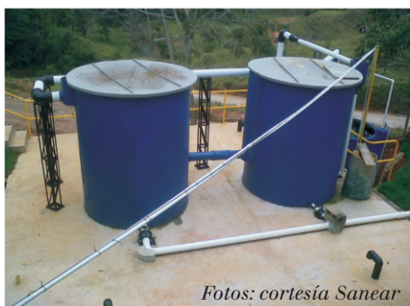
Fotos: cortesía Sanear Planta de tratamiento de agua potable en el Corregimiento Las Mercedes, en el municipio de Puerto Triunfo, Antioquia.
