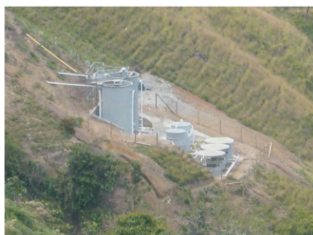
Planta de tratamiento de aguas residuales domésticas del Corregimiento Llanadas, en el municipio de Olaya, Antioquia.
