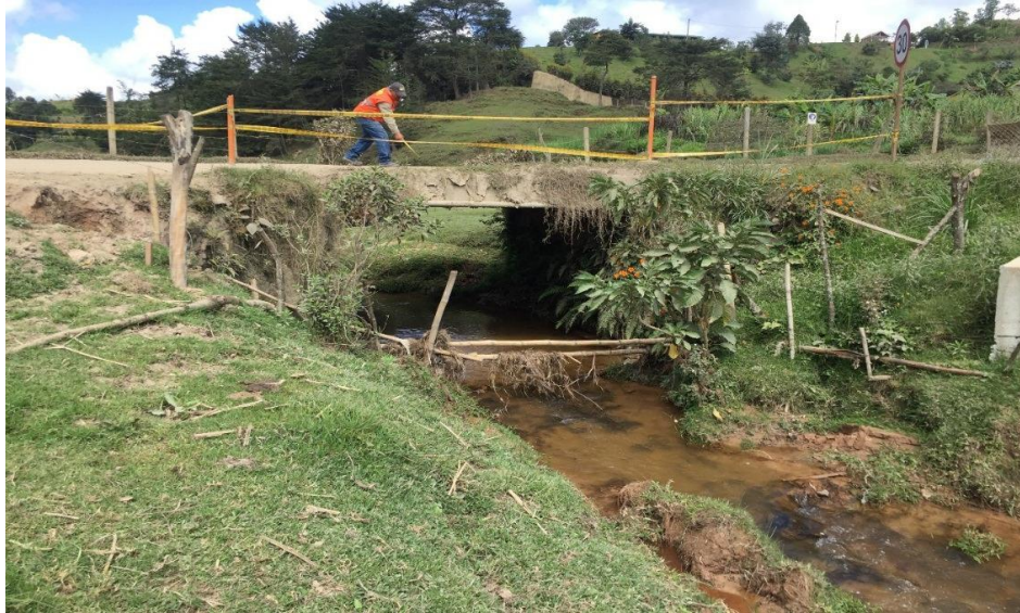
Imagen 1. Sección Longitudinal del puente existente K0+220. Tomada de (Gil Giraldo E. , 2018a)
