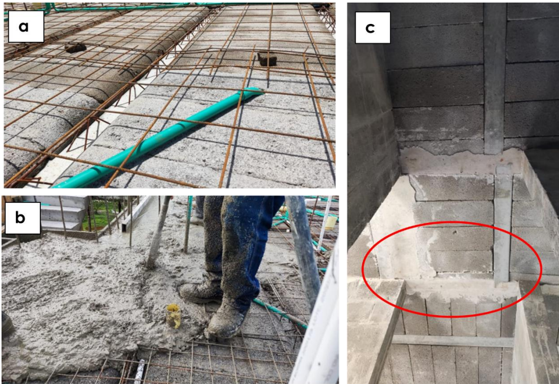
Ilustración 1. Instalación y vaciado de la losa. a) Separación de malla electrosoldada. b) Proceso de vibrado. c) Resultado final del área inferior del proceso de vaciado de la losa.
