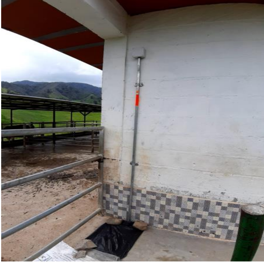
Fig. 10 Canalización DC del SFV.
