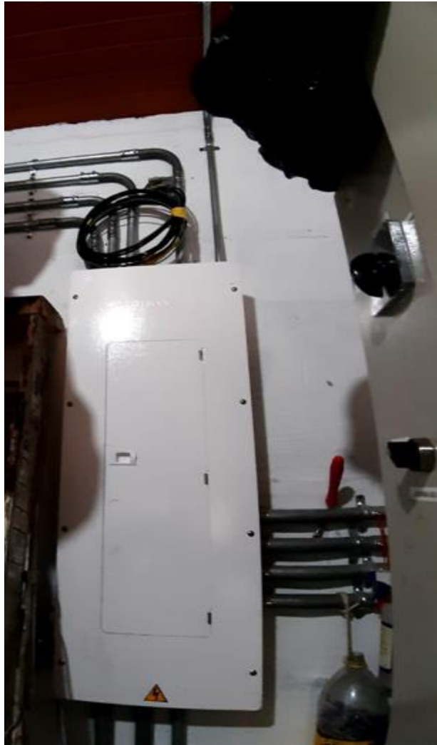
Fig. 12 Llegada a tablero AC PPAL existente.
