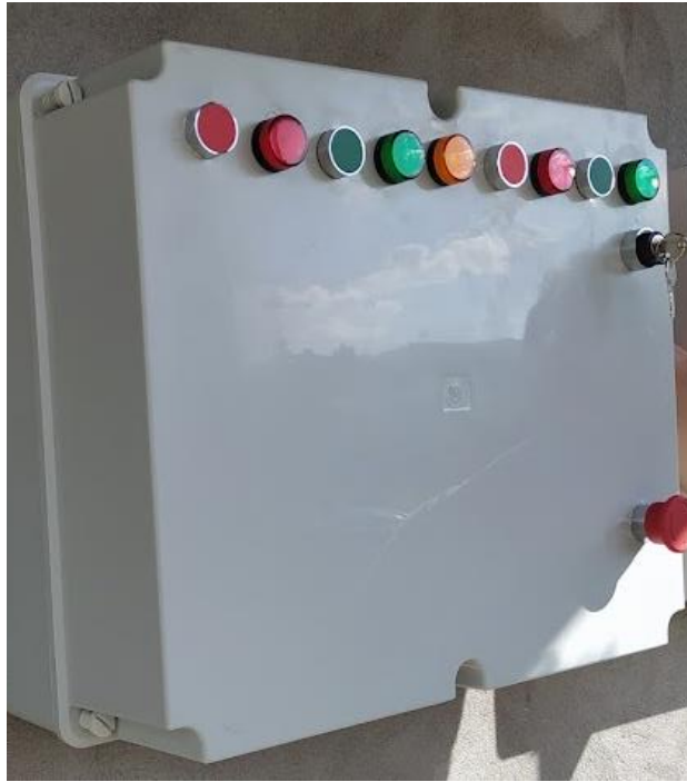
Figura X. Tablero de control de bombas en casa de máquinas. Este corresponde al tablero de control principal del proyecto, donde se controlan todos los equipos del sistema y donde se aloja la tarjeta ordenadora Raspberry Pi.
