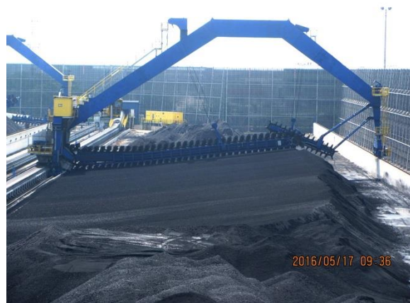
Fig. 7: Reclamador de pórtico
