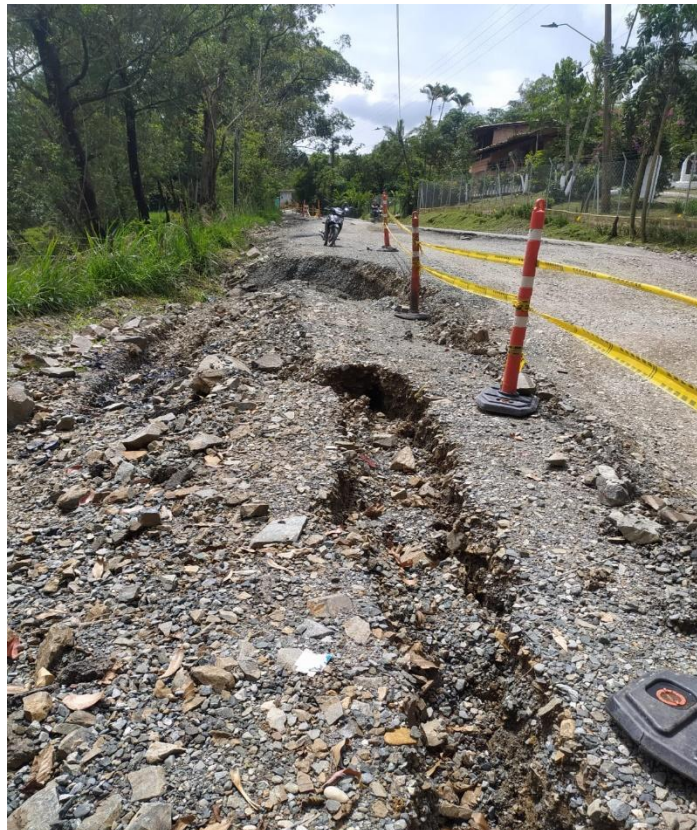
Imagen. 15 Asentamientos diferenciales en la calzada k4+630.
