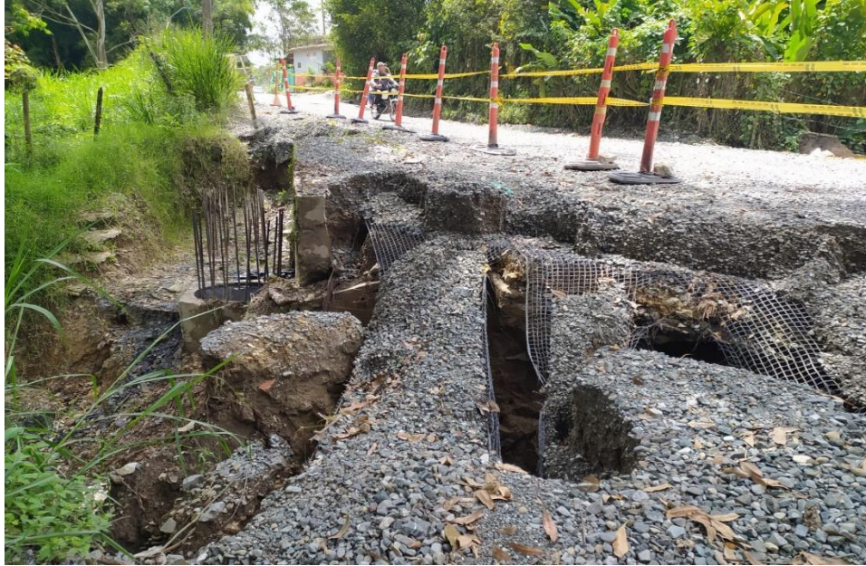
Imagen. 14. Movimientos diferenciales del terreno, exposición de material de refuerzo de la estructura, pérdida de la banca k4+700.
