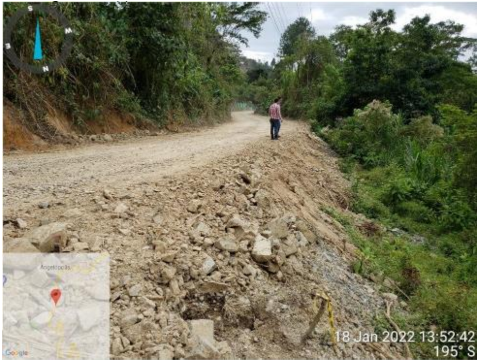
Imagen. 17 Sitio crítico K9+540, pérdida de banca de la vía.
