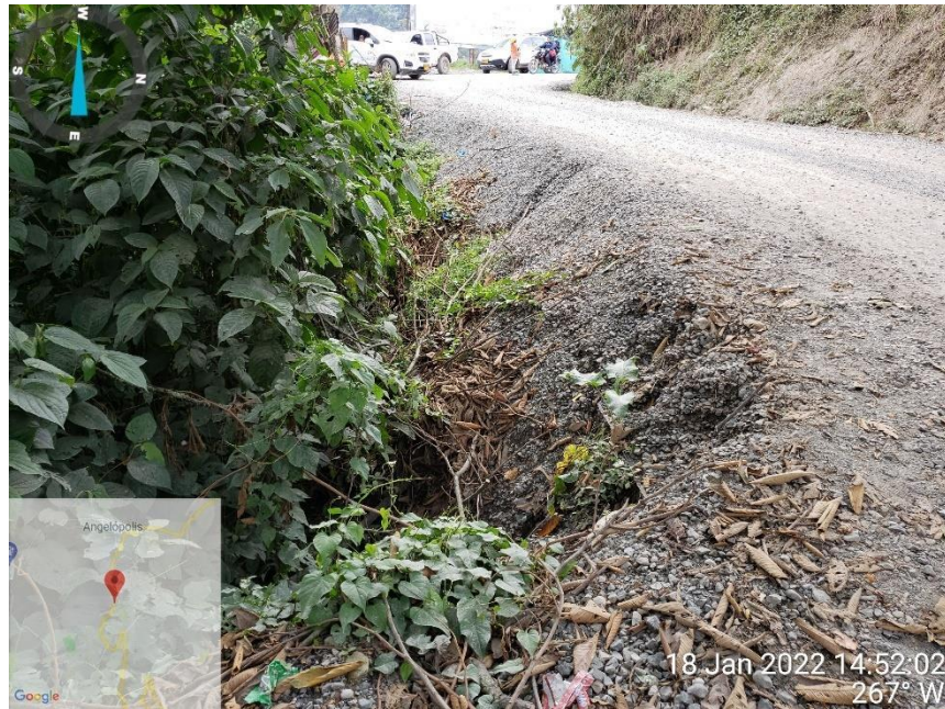
Imagen. 16 Sitio crítico k7+550 socavaciones del talud y pérdida de banca.
