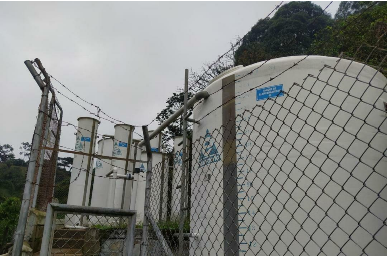
Figura 2. Planta de tratamiento de agua potable del municipio de Sabaneta, Antioquia
