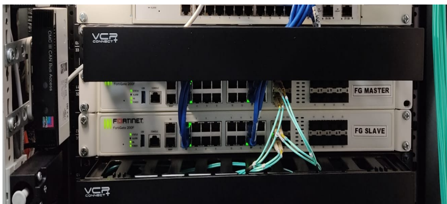
Figura 6. Firewall FortiGate Conexión física.
