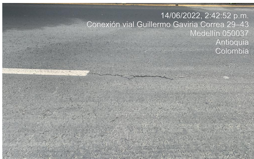
Figura 44. Fisura longitudinal. Fuente: elaboración propia.
