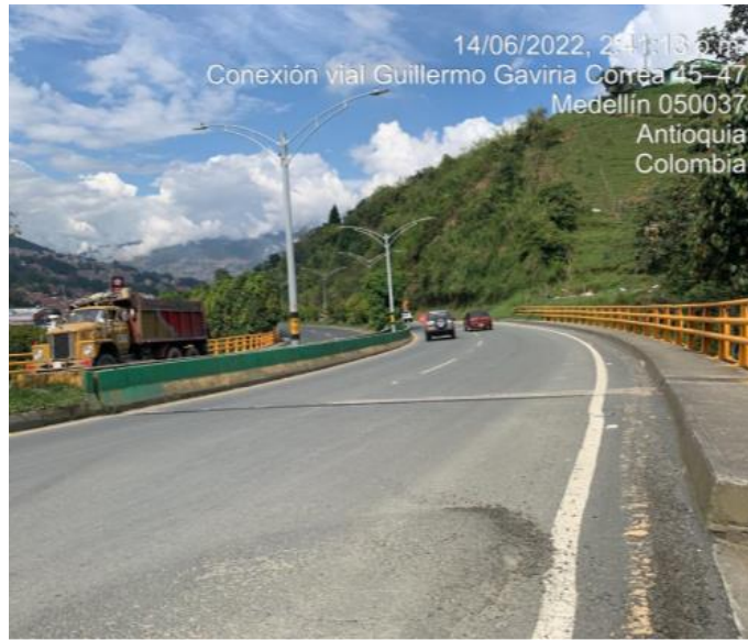
Figura 43. Fisuración por deslizamiento de capas en curva. Fuente: elaboración propia
