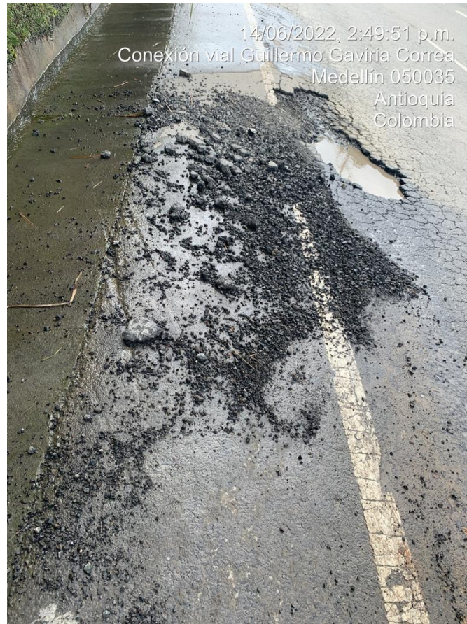
Figura 41. Baches, afloramiento de agua y pérdida de agregado. Fuente: elaboración propia.
