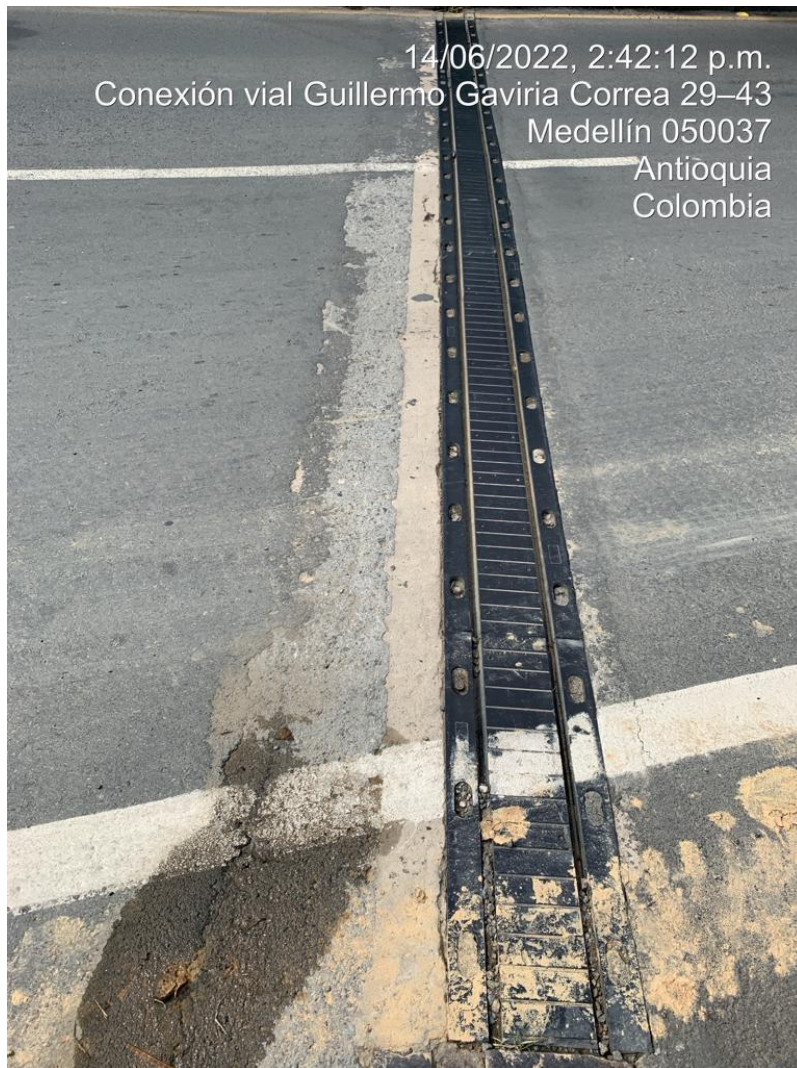
Figura 46. Fisura transversal en junta de construcción. Fuente: elaboración propia
