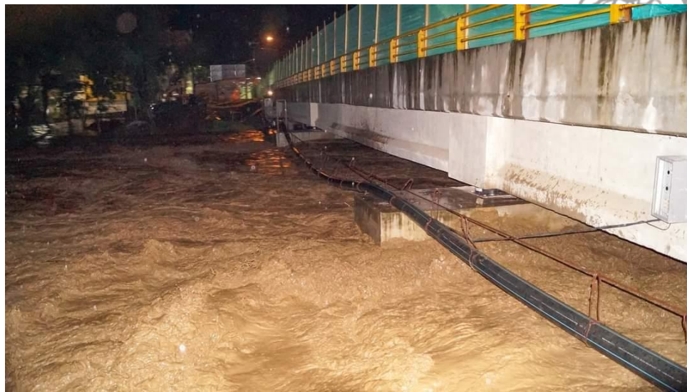
Foto 1: Desbordamiento del río Apartadó a la altura del puente principal, año 2019. Foto tomada por Carlos Alberto Morales.
