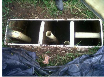
Figura 13. Interior del pozo séptico
